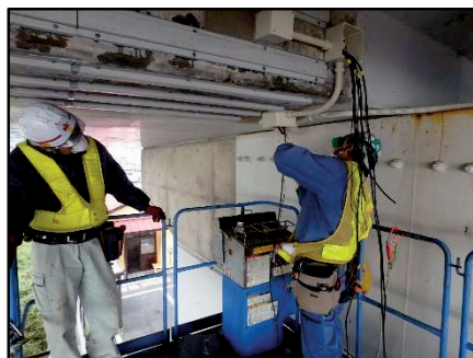
モニタリング用配線配管
